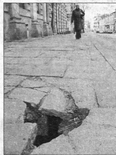
Dziura odsłoniła piwnice
